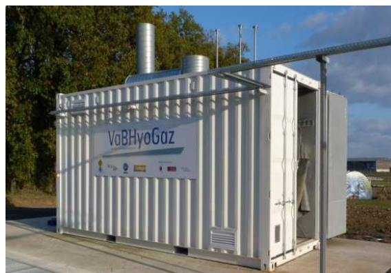
Unité de production d'H2 (10 kg/jour) de qualité 'pile à combustible' par reformage de biogaz, en fonctionnement sur le site de TRIFYL, inauguré le 20 janvier 2014 par le Ministre du redressement productif, M Arnaud Montebourg. (Projet TITEC ADEME, coordinateur : ALBHYON)
